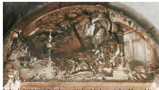
Hôtel du Vieux Raisin = original ½ lune très dégradée
